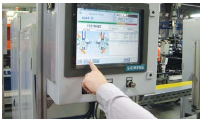
UCB nadzorujący pracę operatorów
